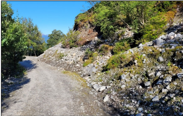
Foto frå «Vonløypa» nedanfor «Bukkane Bruse-brua»/ Gamlestølen – viser lausmasseskråningar til dels utan vegetasjon. Skjeringsfot bør sikrast med tørrmur i naturstein.
